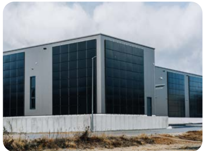
Insgesamt haben wir Solarmodule mit einer Leistung von 340 kW auf unseren Dächern und Fassaden installiert. Damit erzeugen wir mehr Energie, als wir benötigen.
